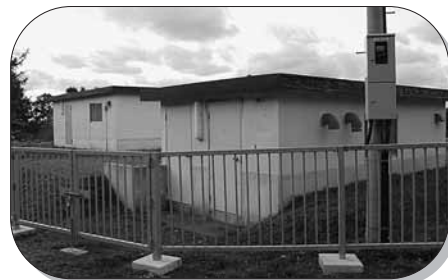
簡易水道施設整備事業として、配水池フェンスの改修工事を実施しました。(事業費242万円)
